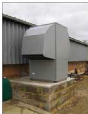
La pompe à chaleur permet de chauffer l'eau qui circule dans les plaques chauffantes en maternité.
