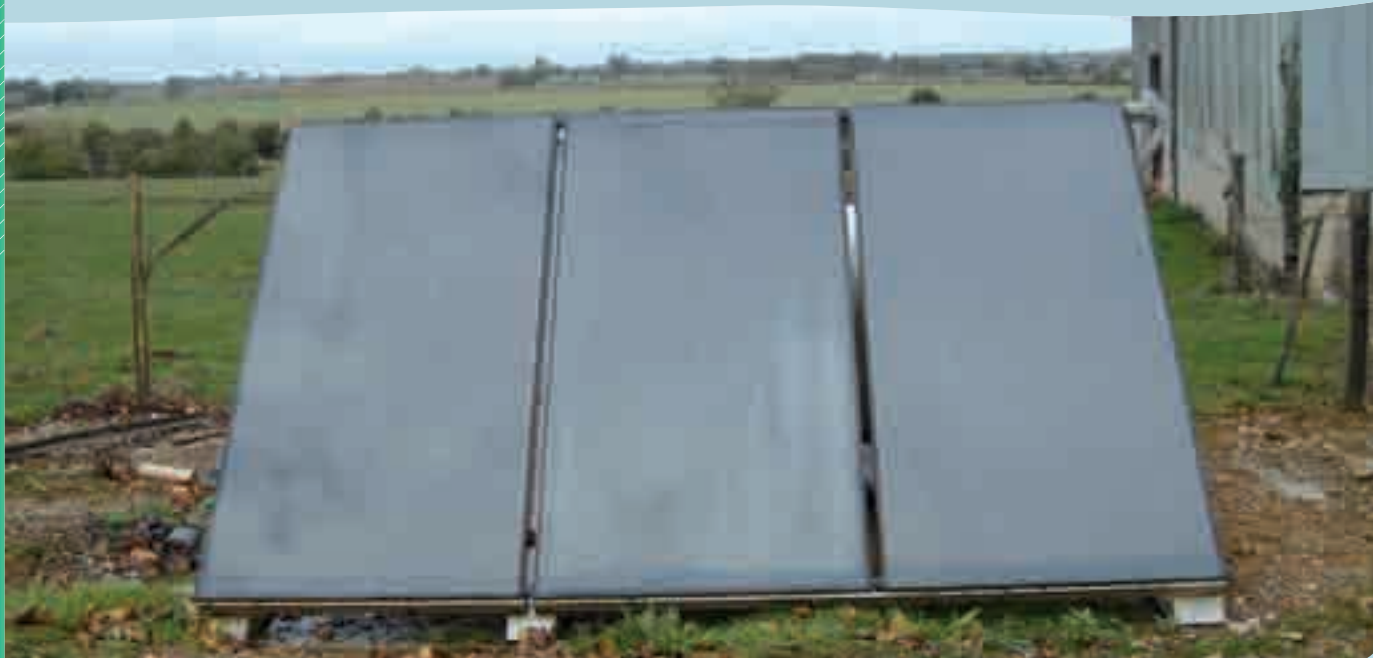
Panneaux solaire thermique, de salle de traite M. Bordeaux, Le Gast, 53 Peuton
