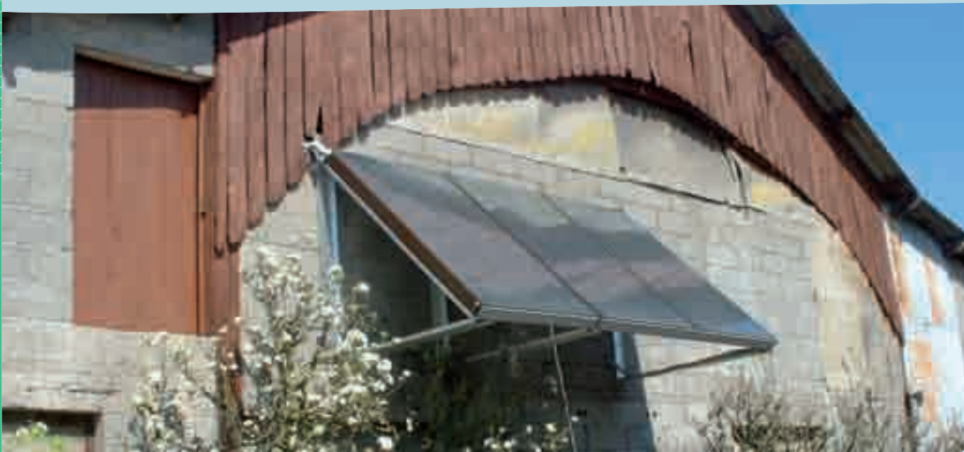
Panneaux solaire thermique, de salle de traite M. Hocdé, La Roche-Portée, 53 La Roë
