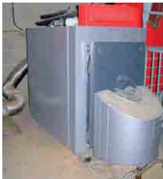
Photo 11: chaudière au sol couplée à un ballon tampon (échangeur)
