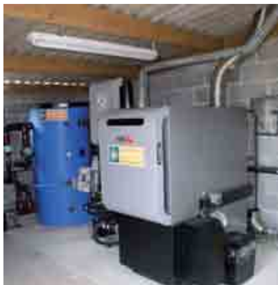
Photo 4: le chauffe-eau est le principal poste de consommation d'énergie estimée à 108 kWh/veau soit 71 % de la consommation totale en bâtiment
