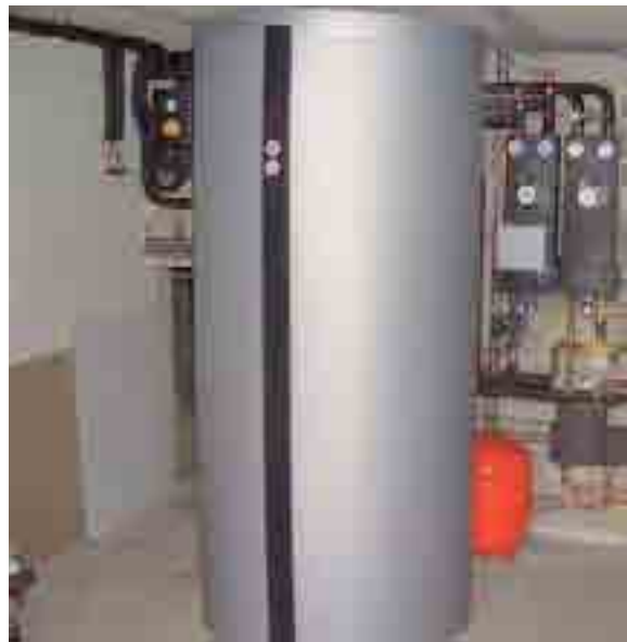
Photo 9 : ballon sous pression
