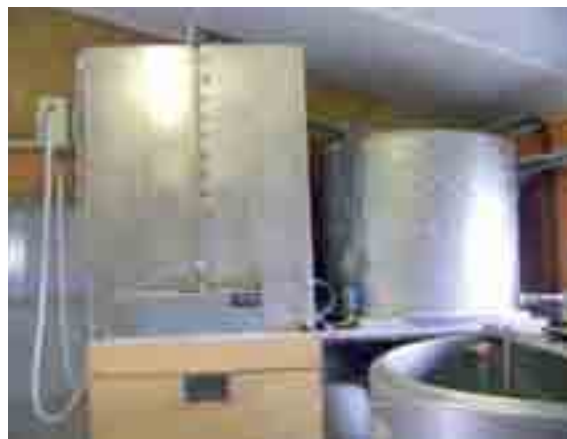
Photo 12 : chaudière de type Le PERCY couplée à un réservoir de stockage en inox à pression atmosphérique.
