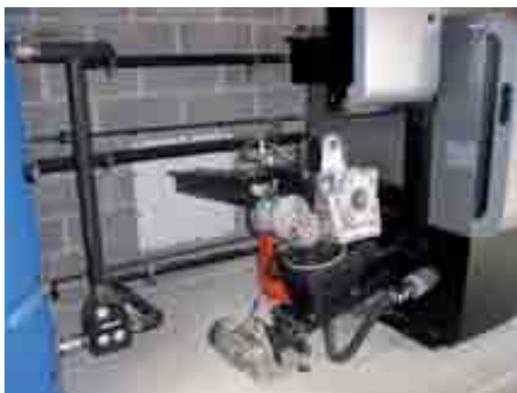
Photo 15 : la plupart des chaudières bois dispose d'une alimentation automatique par vis.
