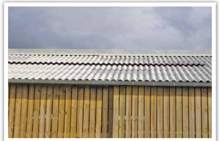
Relais de ventilation : écailles en toiture
